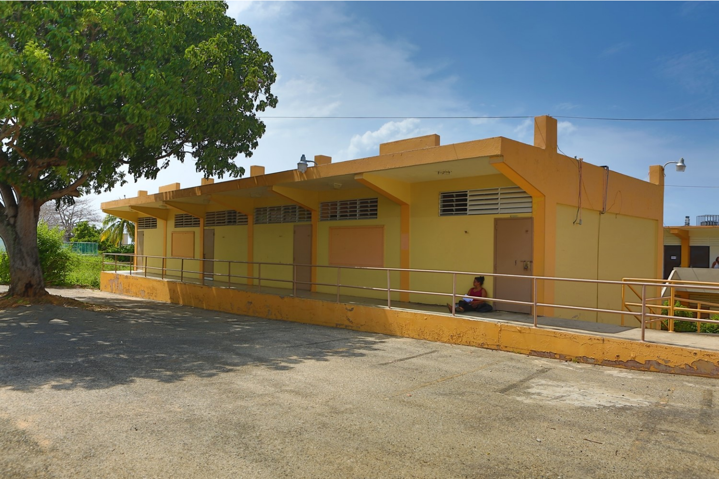
El Prescolar se reubicará en el Edificio Anexo C en los edificios Anexos.
